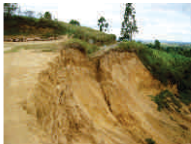
Vía Las Cruces II derrumbada
